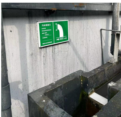
污水排放口标识
