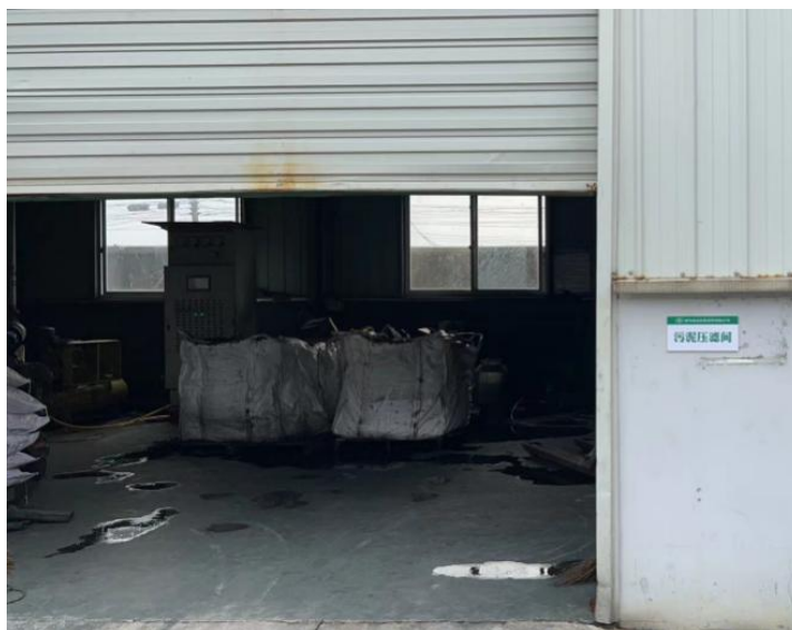
污泥压滤间照片
