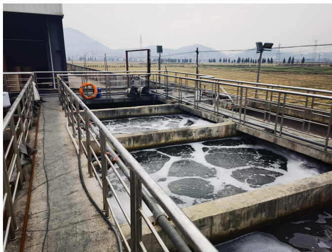
污水处理站照片
