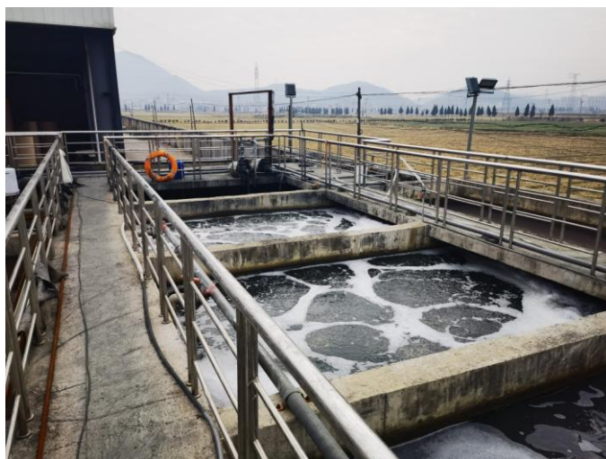
污水处理站照片
